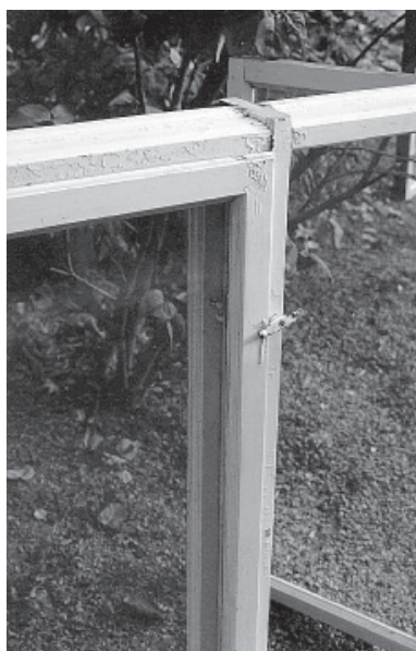
Figur 8.2 Överfalsade innerbågar utan gångjärn.
