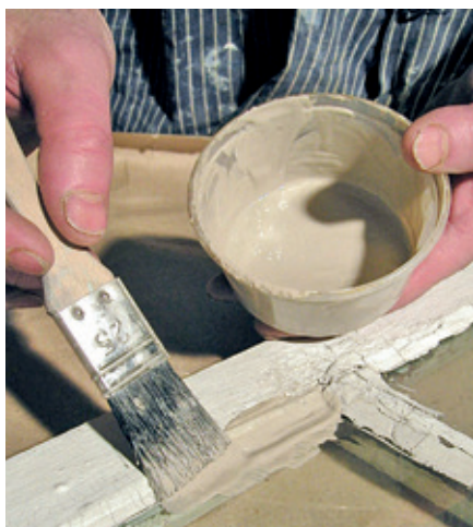
Kittvälling, enkel "fördröja åldrandet" åtgärd.
